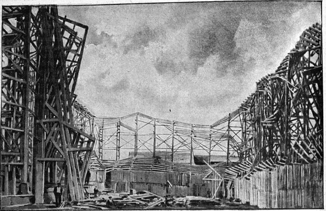
LA CONSTRUCTION DES MONTAGNES AU VILLAGE SUISSE. — Construction en charpente de la carcasse.
